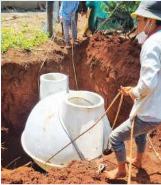
Hình 9. Lắp hệ thống thu Biogas từ nước thải cho mô hình 2023
